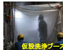
仮設洗浄ブース
